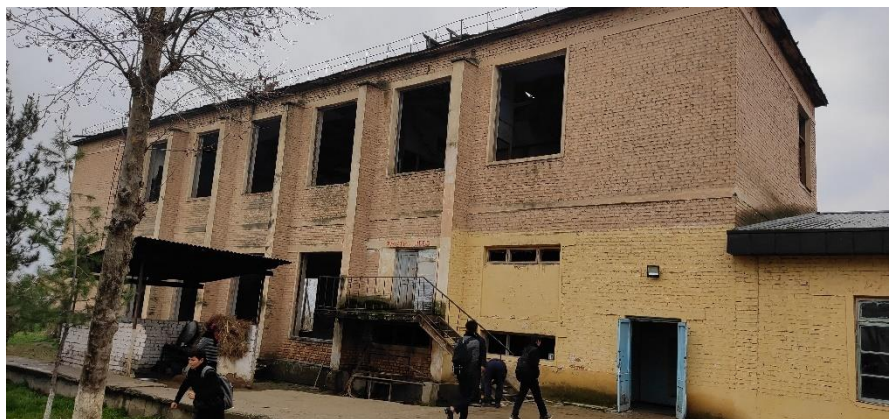
Фото: Состояние учебного корпуса актового и спортивного зала
