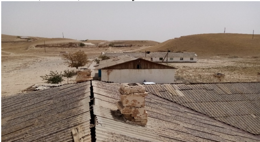
Фото: Состояние кровли учебных корпусов СШ№25 села Машгаль сверху
