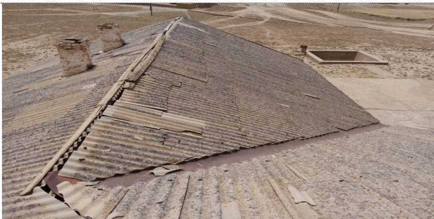
Фото: Состояние кровли учебных корпусов СШ№25 села Машг'ал сверху
