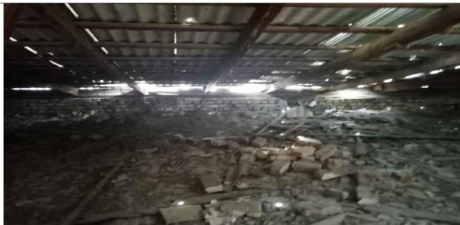
Фото: Состояние деревянных конструкции со стороны чердачного помещения учебного корпуса
